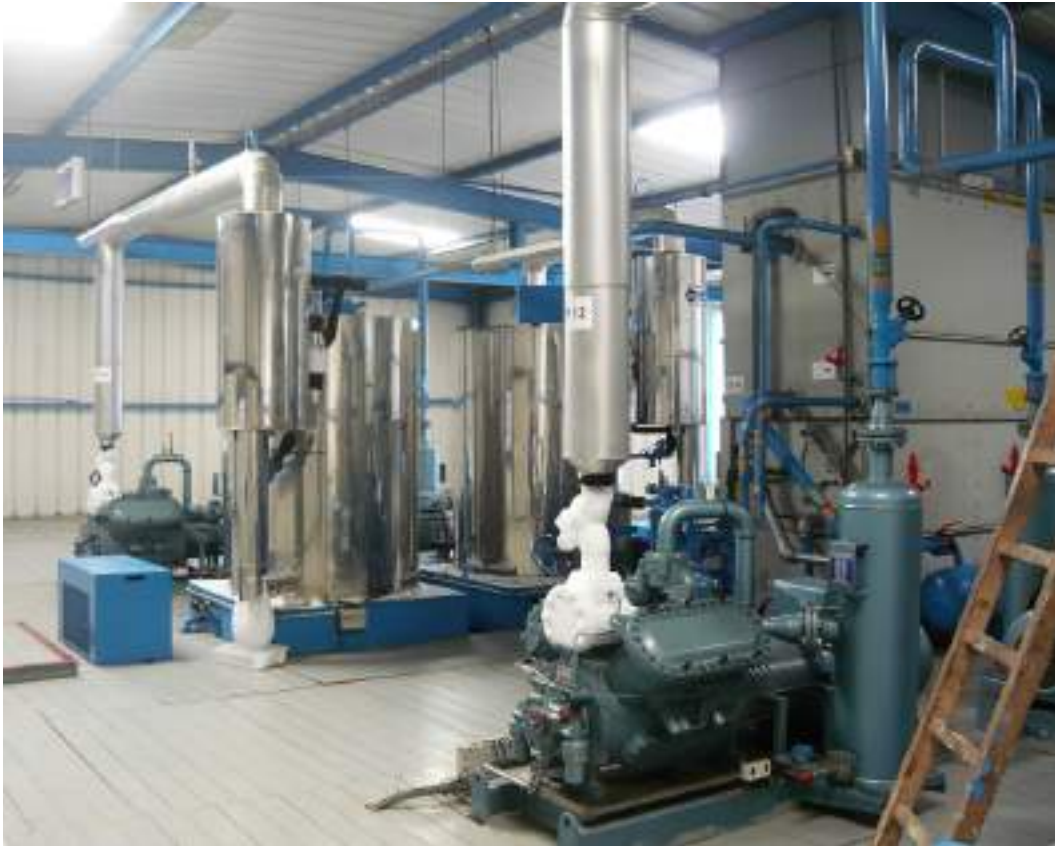
Agadir, Marocco. Sala macchine di uno stabilimento per la produzione giornaliera di 120 ton di scaglia piatta
