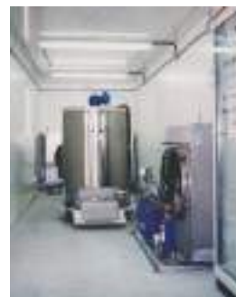
Interno del container ISO con sala macchina installata sopra ad un deposito ghiaccio
